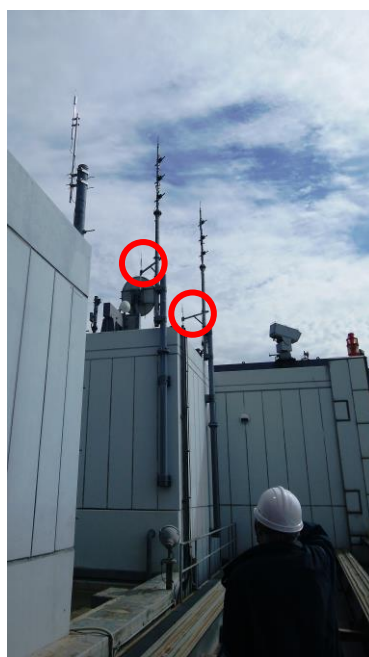
屋上アンテナ（○部分）
